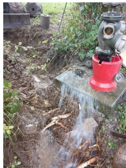
Rupture de la conduite d'eau aux Liorats, rapidement réparée le 11/10/2024
